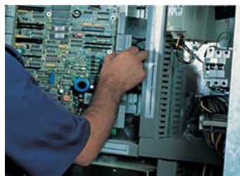
Quadro de Comando de Elevador das Oficinas da Atlas Schindler
